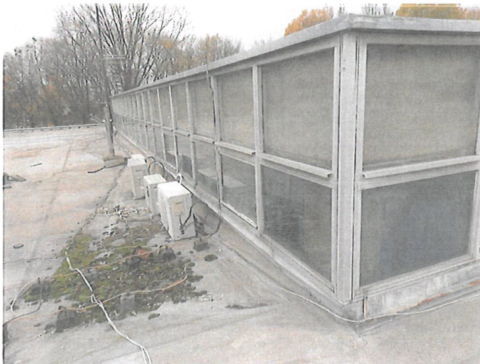
Aluminijska bravarija na uvučenom dijelu objekta na ravnom krovu, kroz stijenke bravarije voda ulazi u unutrašnjost objekta
