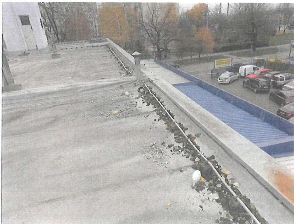
Korodirani limeni opšavi
