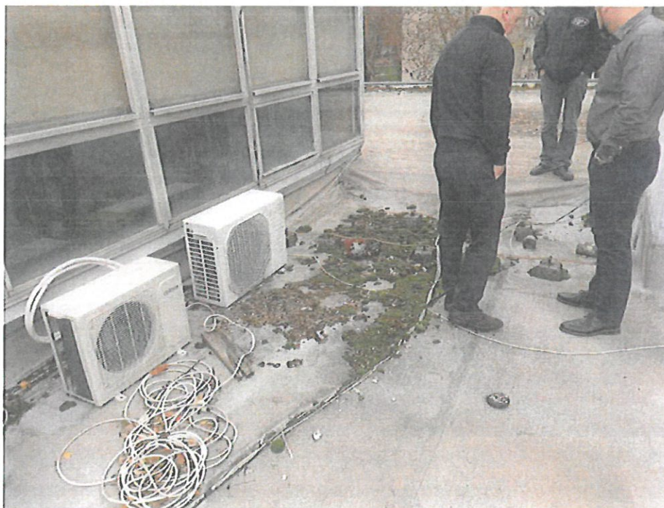
Ravni krov koji treba očistiti, pregledati HI foliju i soffone, sanirati oštećena mjesta, zamijeniti opšave i gromobransku traku
