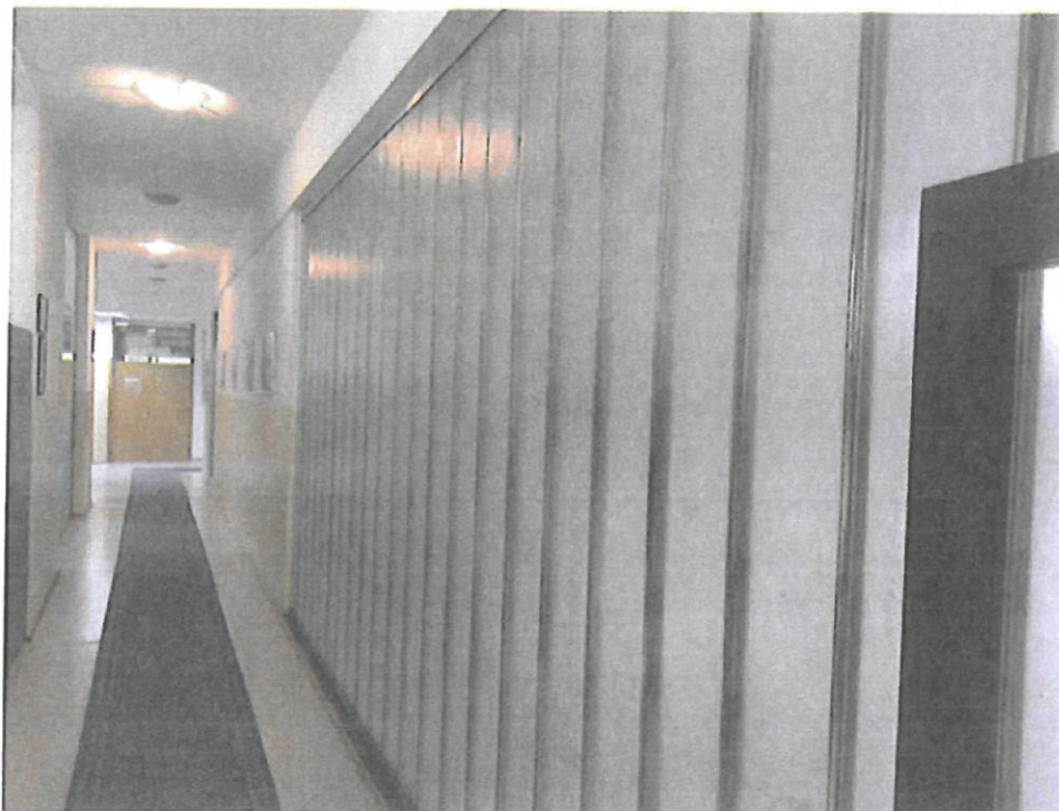
Oštećeni kopilit na hodnicima u uredima na 1.katu koji treba zamijeniti aluminijском bravarijom
