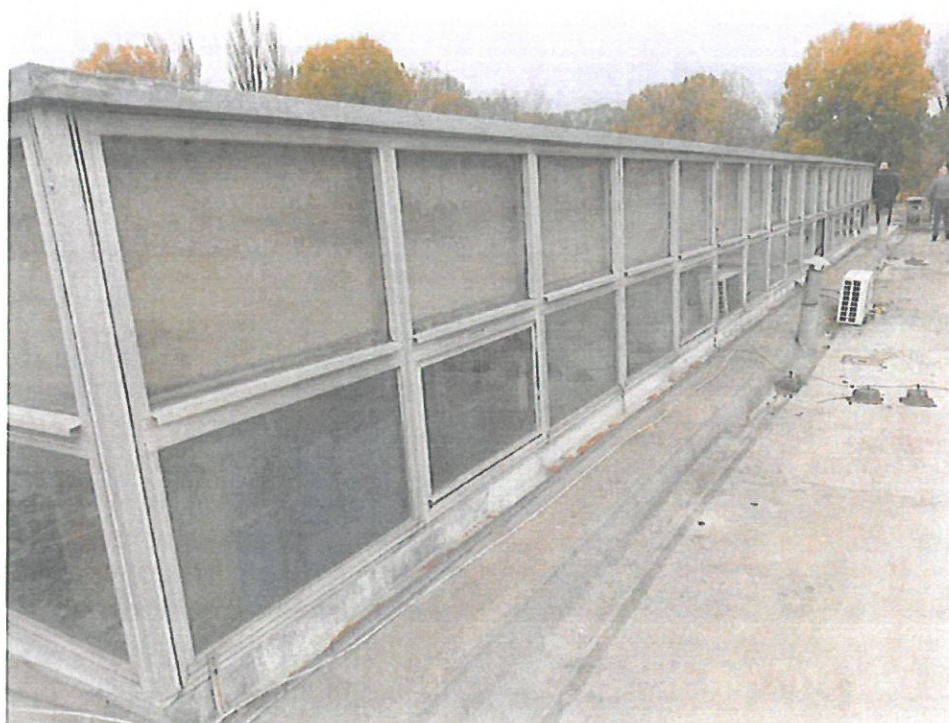
Aluminijska bravarija na uvučenom dijelu objekta na ravnom krovu, kroz stijenke bravarije voda ulazi u unutrašnjost objekta
