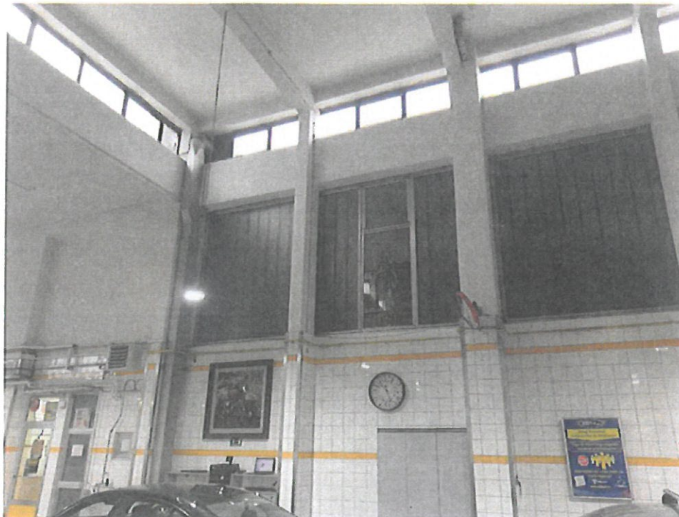
Oštećeni kopilit na hodnicima u uredima na 1.katu koji treba zamijeniti aluminijskom bravarijom
