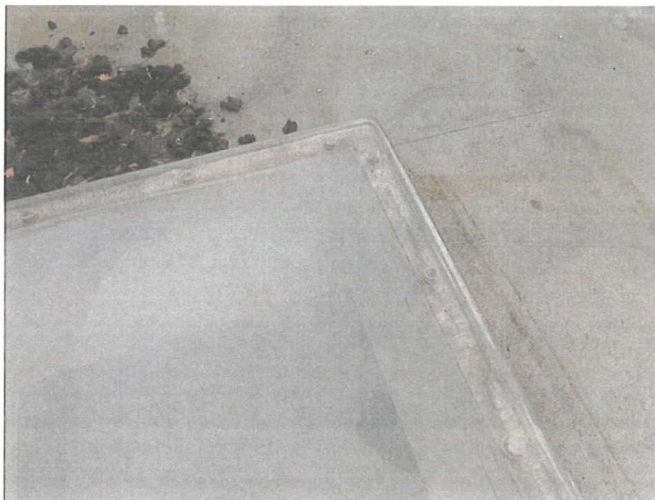
Oštećene krovne kupole
