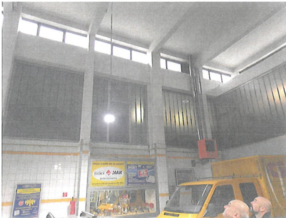
Oštećeni kopilit na hodnicima u uredima na 1.katu koji treba zamijeniti aluminijskom bravarijom
