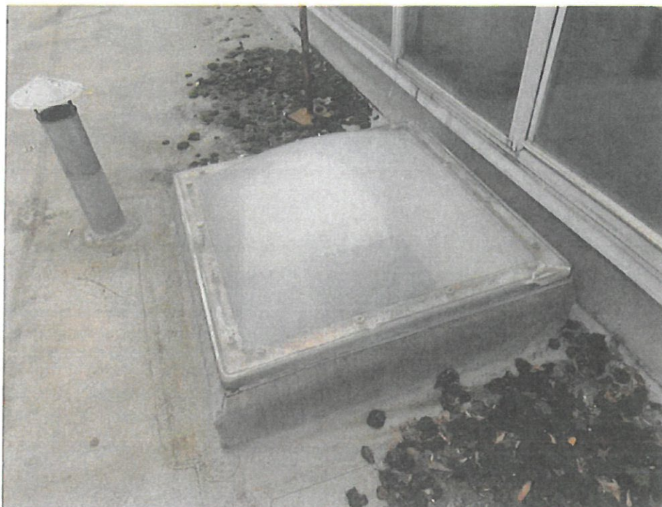
Oštećene krovne kupole
