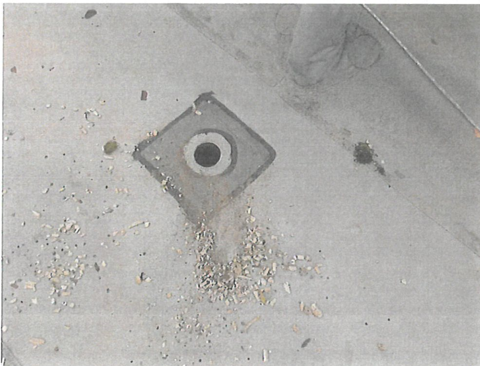
Krovni sifoni koje treba pregledati, očistiti i ukoliko su oštećeni sanirati
